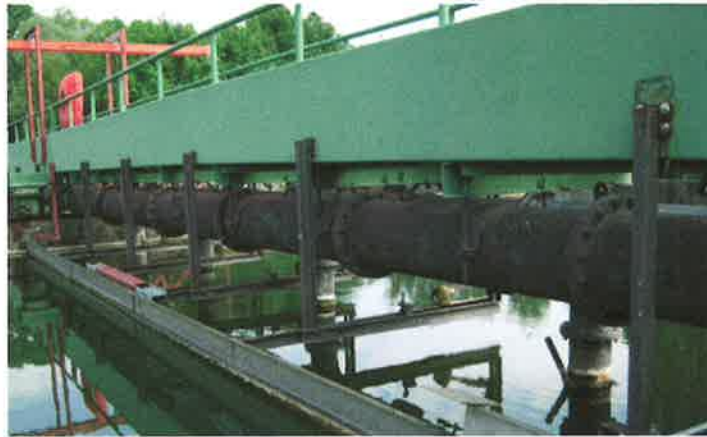
Abbildung 7: Räumler und Schlammabzug des NKB
